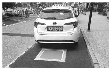
스웨덴 예테라마에 위치한 전기차 무선충전시설.
