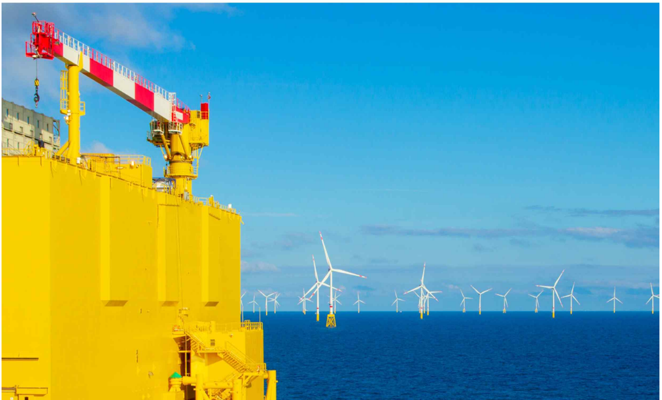
북해의 풍력 발전소 왼쪽으로 생산한 에너지를 내륙에 전달하는 초고압 직류 송전(HVDC) 변전소의 모습이 보인다.
